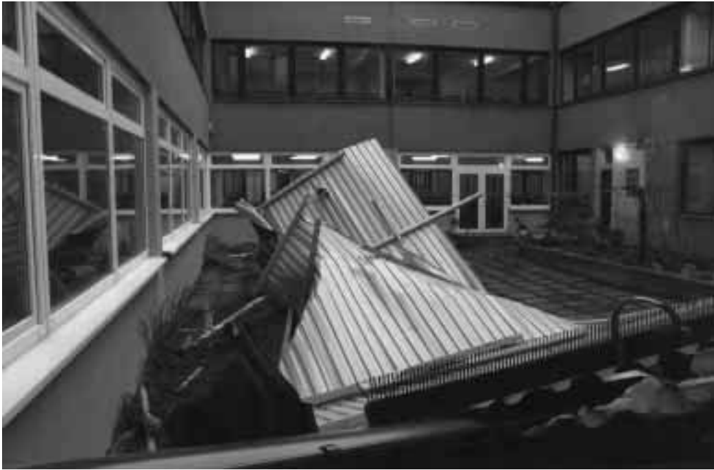
Zničená střecha na ZŠ J. Wericha ve Španielově ulici.
